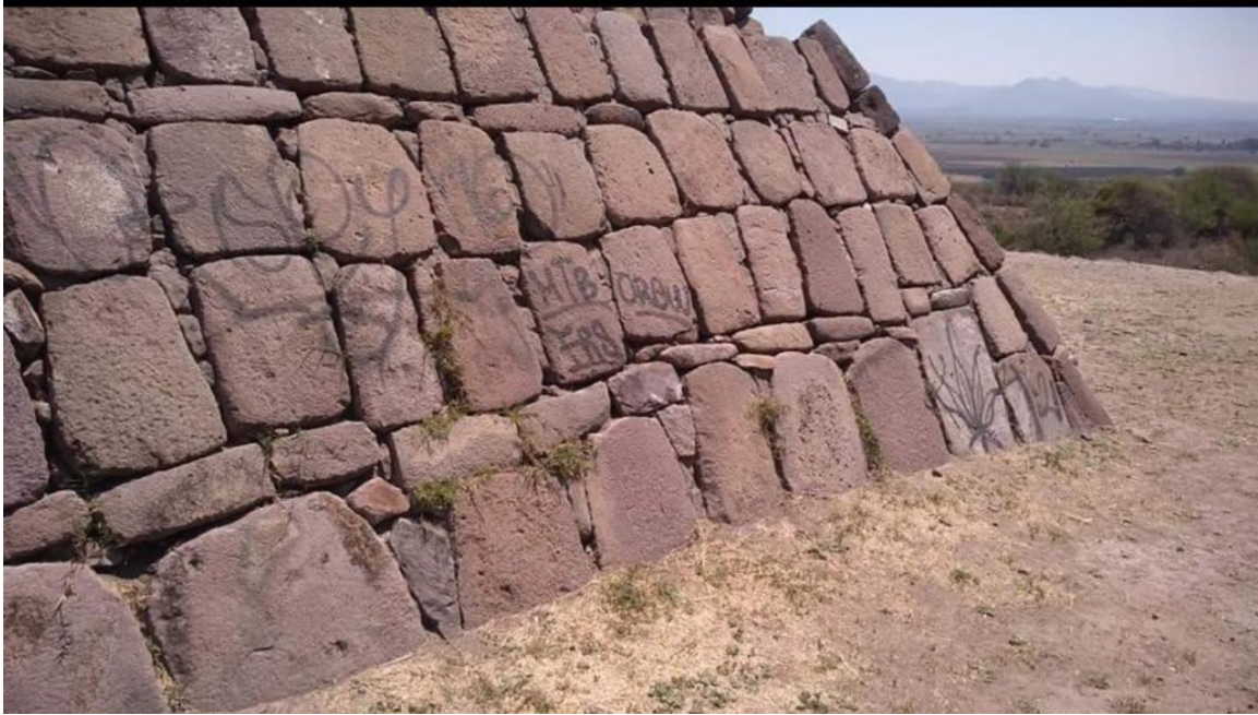
Imagen 2 Graffiti en el muro sur de la estructura 10 (fotografías proporcionadas por Génesis L. Escobar 26/05/2020).
