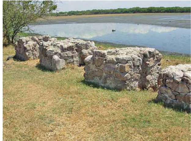
Figura 9. Restos de las compuertas de salida de una caja de agua. Fotografía del autor, abril 2011.
